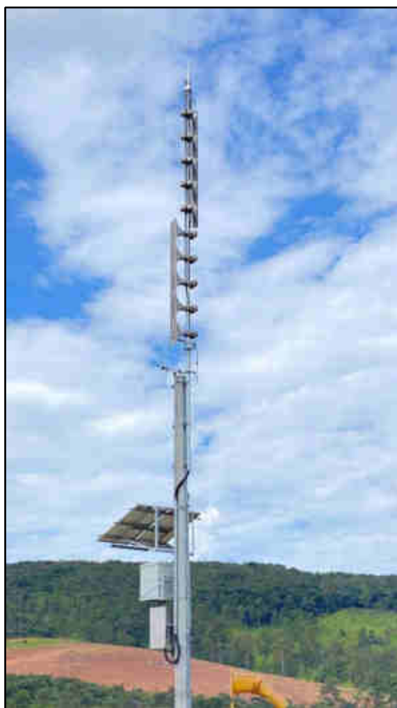
Figura 7.1 – Sirene implantada próximo a ZAS da mancha de inundação da Barragem B4
