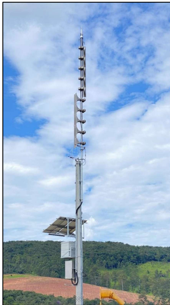
Figura 13.1 – Sirene implantada próxima a ZAS da mancha de inundação da estrutura de contenção de rejeitos B4
