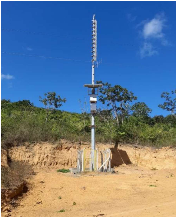
Figura 13.1 - Sirene implantada próximo a mancha hipotética de inundação da Barragem Rancho Casca
