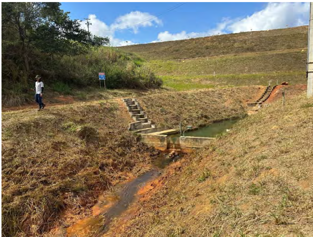
Foto 15 – Medidores de vazão.
