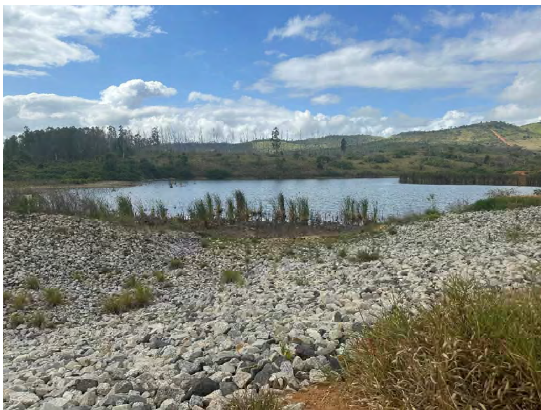
Foto 16 – Emboque do canal extravasor – sem passagem de água.
