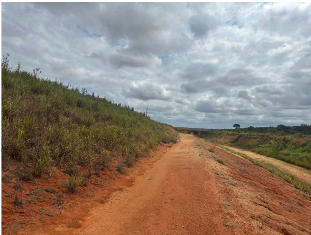
Foto 19 – Talude de corte do Canal extravasor – sem sinais de empoçamento de água. Vista em direção à barragem
