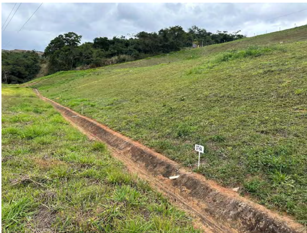
Foto 22 – Talude de jusante – Face entre as cotas 595 e 601 - Vista para a ombreira direita.
