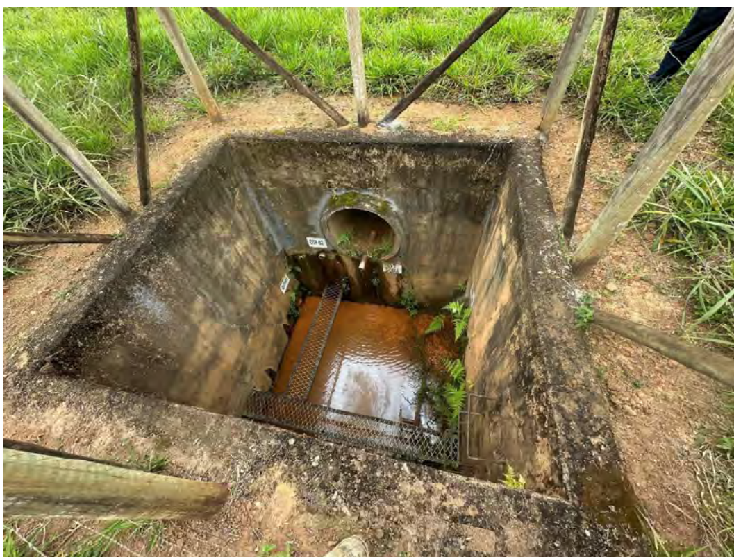
Foto 28 – Caixa de coleta dos Drenos.
