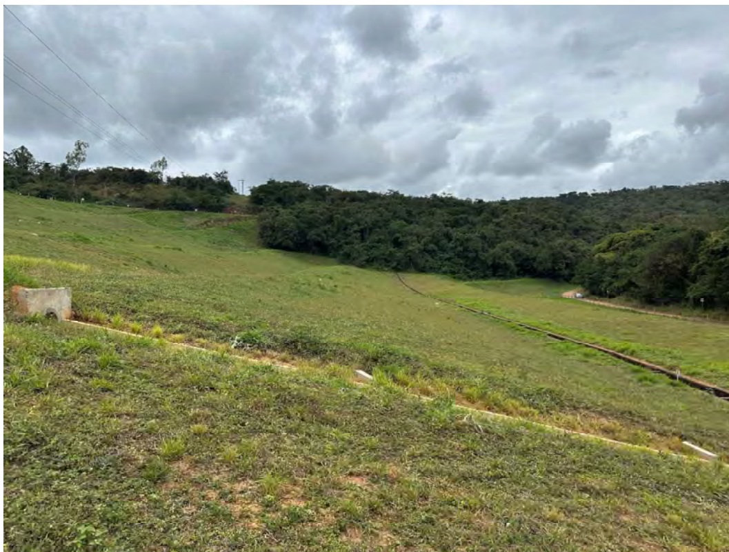
Foto 25 – Talude de jusante – Face entre as cotas 590 e 595 - Vista para a ombreira esquerda.
