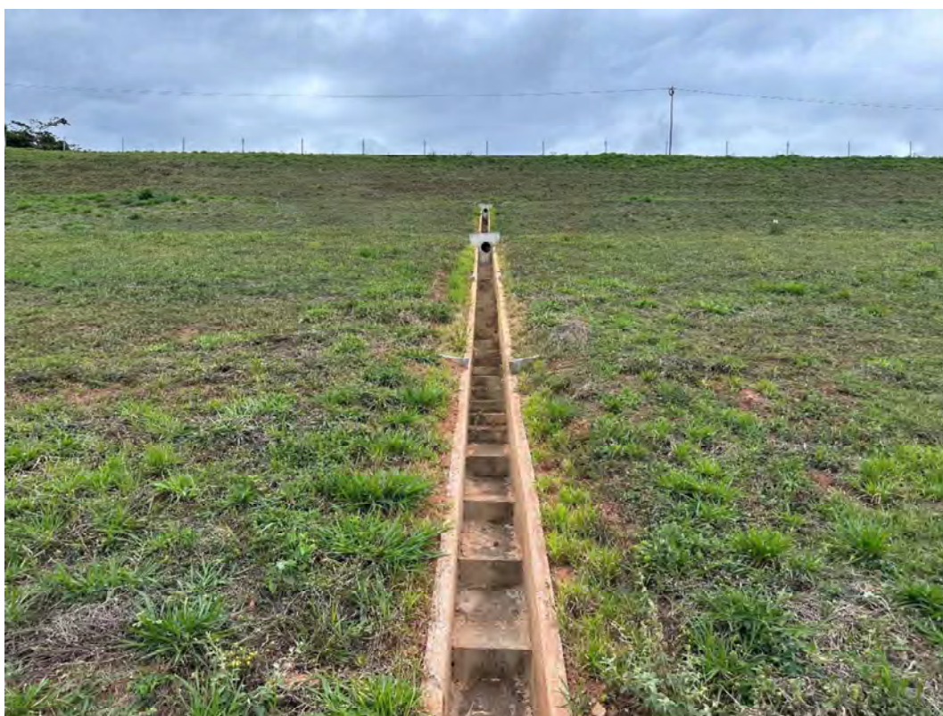
Foto 18 – Talude de jusante – nova descida d'água em degraus conectando as drenagens das bermas 601 e 608 (est. 12).
