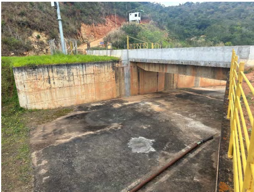
Foto 28 – Emboque do extravasor – ombreira esquerda.
