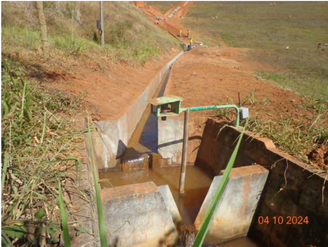
Foto 3 – Reconformação da descida hidráulica no contato com a ombreira direita executada. (fonte: inspeção de campo realizado pela equipe da unidade em 04/010/24).
